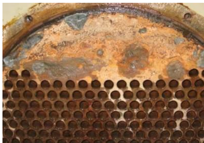
Obr. 13.18 Ukážka zaneseného kotlového výmenníka tepla (Magnus, 2019)
