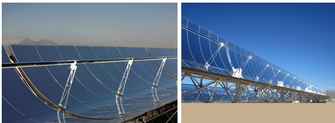
Obr. 10.5 Lineárne parabolické zrkadlá (Energy, 2021; Sunwindenergy, 2021).
